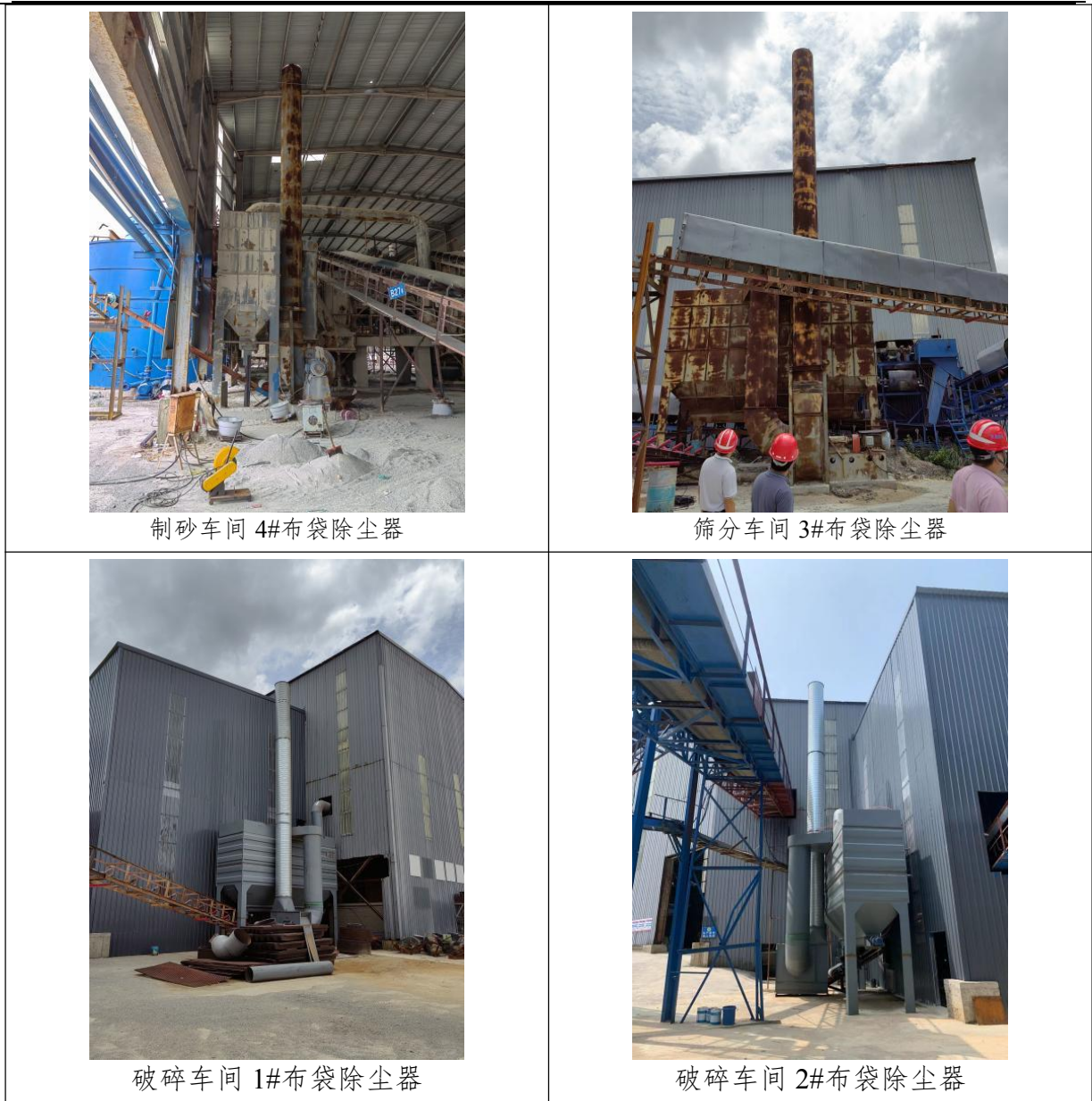
图 6.2-5 废气治理设施现状照片
