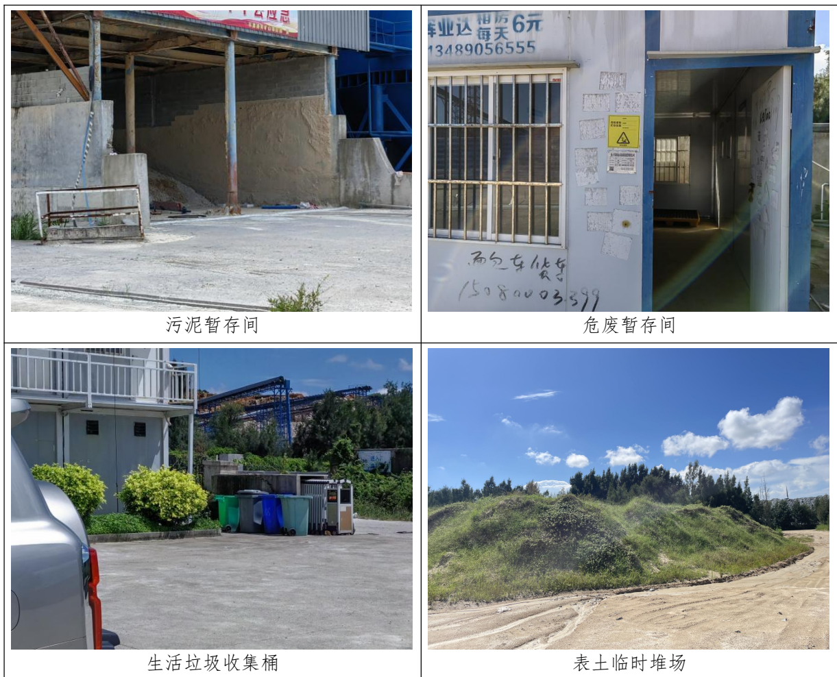
图 6.2-6 固体废物治理设施现状照片
