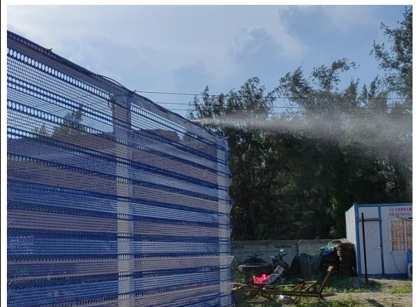
挡墙喷淋设施
